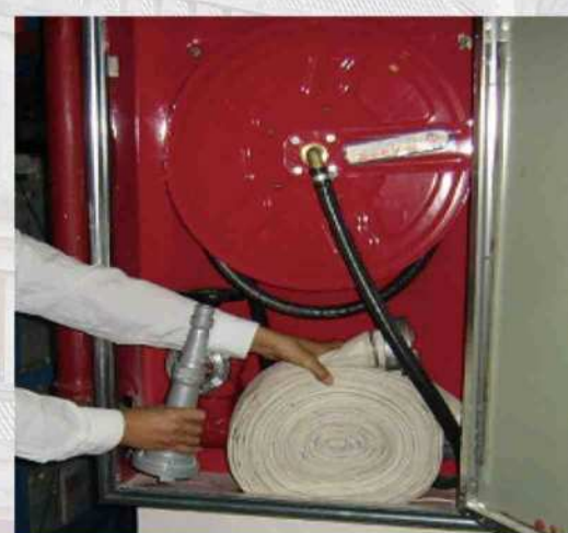
打开消火栓门 取出水枪水带
