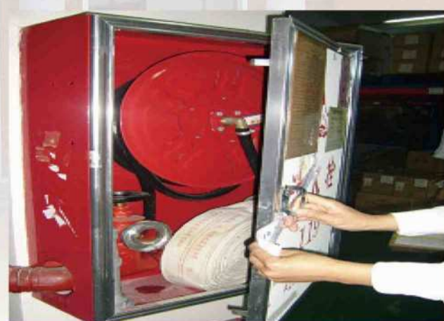
打开消火栓 取出小水枪
